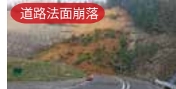
道路法面崩落
